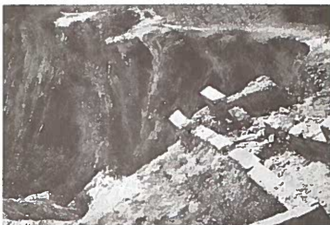
Abb. 8: Oberflächennaher Anbruch, der durch unsachgemäßen Straßenbau verursacht wird. (im "Kakani"-Einzugsgebiet) Der talseitige Hang ist durch unsachgemäße Entwässerung erodiert, der Hangboden dadurch teilweise abgerutscht. Es ist ein Hauptproblem, daß es keine genügende Absprache zwischen den zuständigen Organisationen, der Abteilung für Straßenbau und Abteilung für Erosions-Kontrolle, gibt.
