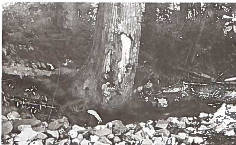
Abb. 4: Überalterte Ufervegetation und in das Abflußprofil einwachsende Bäume. Beim Eintritt einer Hochwasserkatastrophe ist hier eine breit angelegte Zerstörung der Biozönose zu erwarten. Die Unholz- und Geschiebeführung des letztjährigen unbedeutenden Hochwassers hat an Stamm und Wurzeln bereits deutliche Spuren hinterlassen.
