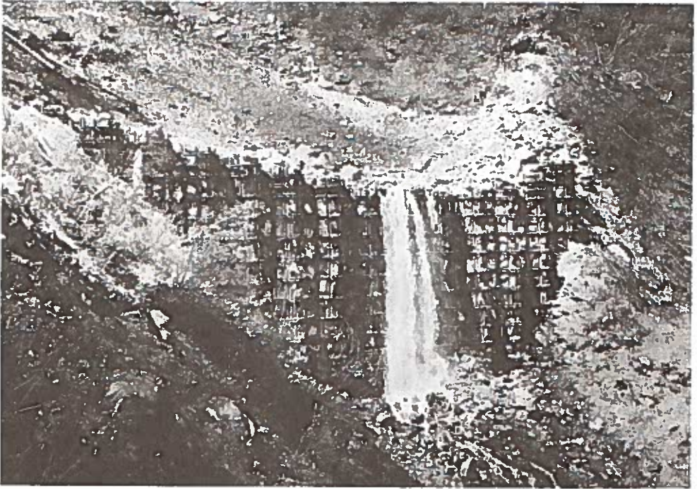
Abb. 4: Die Reihenkorbsperre im Hopfgartnerbach, Osttirol, mit Lawinenablagerungen im Stauration
