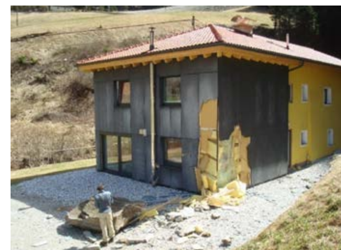
Abb. 1: Steinschlag: Schadblick 2011 und Sachschaden am Gebäude
