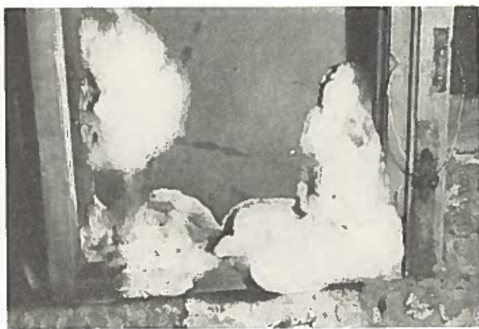
Abb. 10. Fensterrahmen wurden im Frühjahr in einem mit Hausschwamm ( Merulius lacrymans ) versauhten Keller abgestellt. In der Folgezeit wurden sie vom watteartigen Myzel dieses Pilzes überwachsen und zerstört
