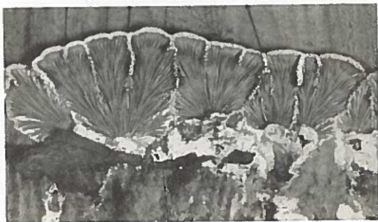
Abb. 30. Spaltblättling ( Schizophyllum commune ), aus einer neugebauten Dachkonstruktion hervorgewachsen
