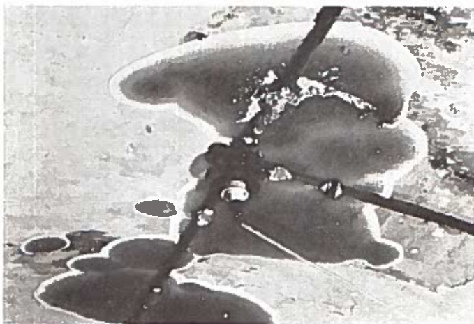
Abb. 6. Fruchtkörper eines echten Hausschwammes ( Merulius lacrymans ), welcher aus der Decke eines Kellergewölbes hervorgewachsen ist. Die Nährstoffe für seine Entwicklung bezieht der Pilz aus dem darüberliegenden Fußboden. Zum Teil wurde auch die elektrische Leitung vom Pilzmyzel überwachsen.
