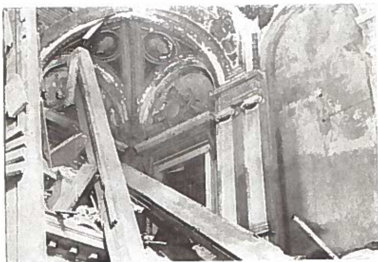
Abb. 7. Der Einsturz dieser Dachkonstruktion wurde durch Hausschwammbefall ausgelöst (phot. K. Lohwag)
