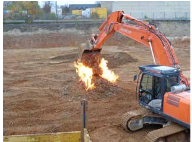
Abb. 9: Selbstentzündung während dem Nassaushub.
