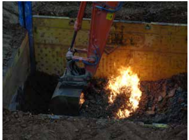
Abb. 10: Brand während Nassaushub.
