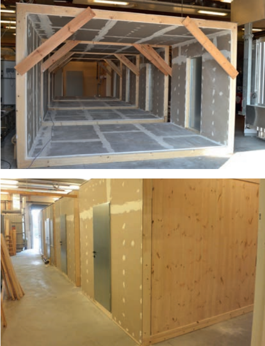
Abb. 24: Vier neue Modellräume im Technikum am UFT (Universitäts- und Forschungszentrum Tulln) Fig. 24: Four new model rooms in the technical center at the UFT (University and Research Center Tulln)
