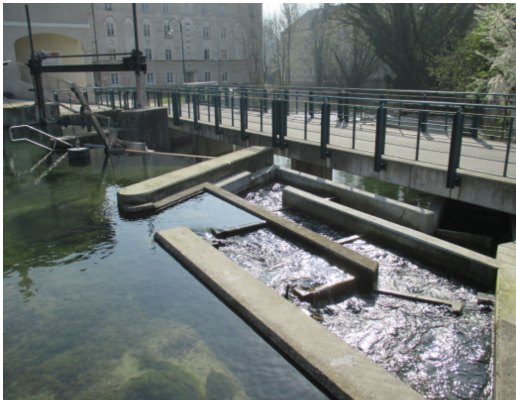
Abbildung 53: Fischaufstiegshilfe in Steyr, Oberösterreich
