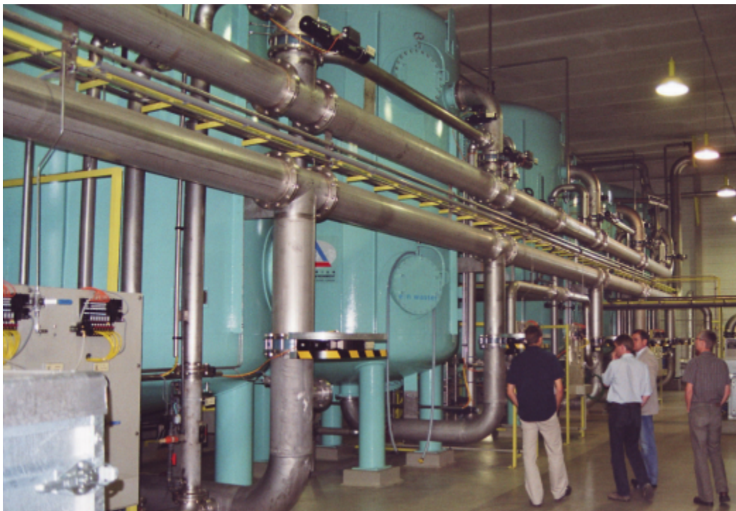
Abbildung 63: Biologische Nitratentfernungsanlage der EVN, Obersiebenbrunn im Marchfeld, Niederösterreich
