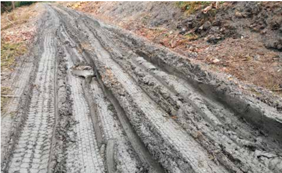
Abbildung 3: Die technische Funktionalität der Forststraße ist aufgrund unzureichender Tragfähigkeit nicht gegeben.
