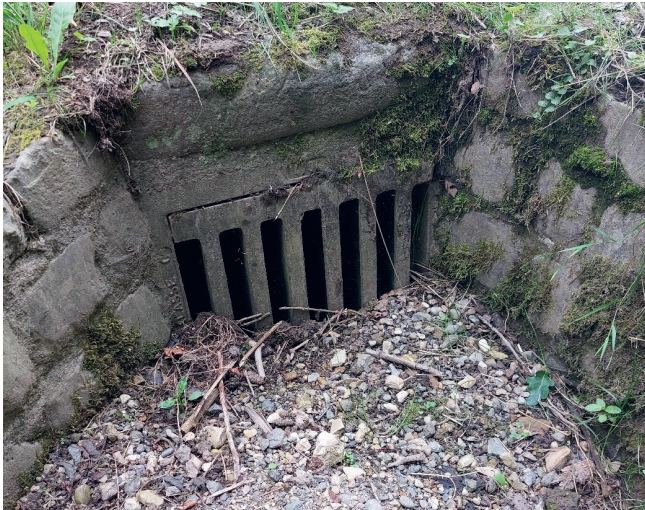
Abbildung 2 Verstopfter Rechen. (Foto: Ammar Fallaha)
