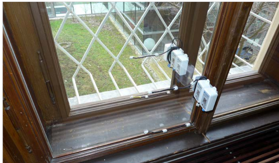
Teil der Online-Messtechnik an einem der drei Fenster des Objekts in Wels
