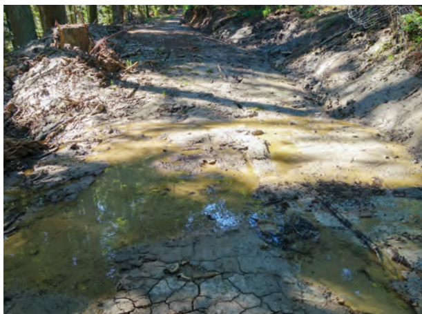
Abbildung 6: Beeinträchtigende Erschließungsmaßnahme durch einen Quellbereich, Axel Wedler, 2018
