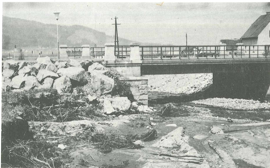
Bild Nr. 6: Gefährdete Straßenbrücke durch das Hochwasser des Gleinbaches im Unterlauf desselben im Bezirk Knittelfeld in der Steiermark (April 1972)
