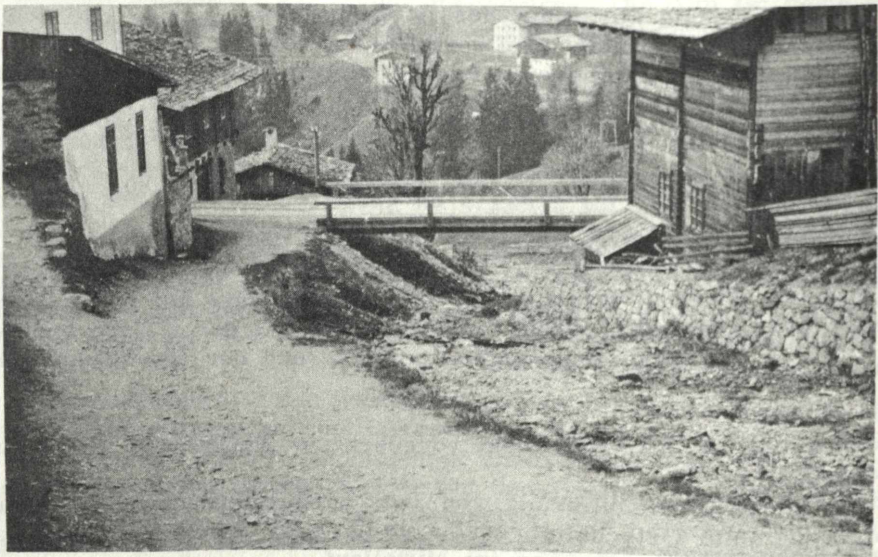
Abb. 2: Die Bundesstraßenbrücke nach dem Hochwasser im September 1965 mit unterwühlten Widerlagern.
